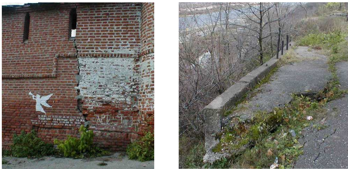
Рис. 6. Трещина у подножия Печерского монастыря, разломившая его стену
